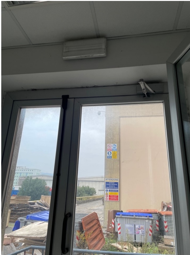
FOTO 25 USCITA DI SICUREZZA SU SCALETTA – PIANO TERRA
